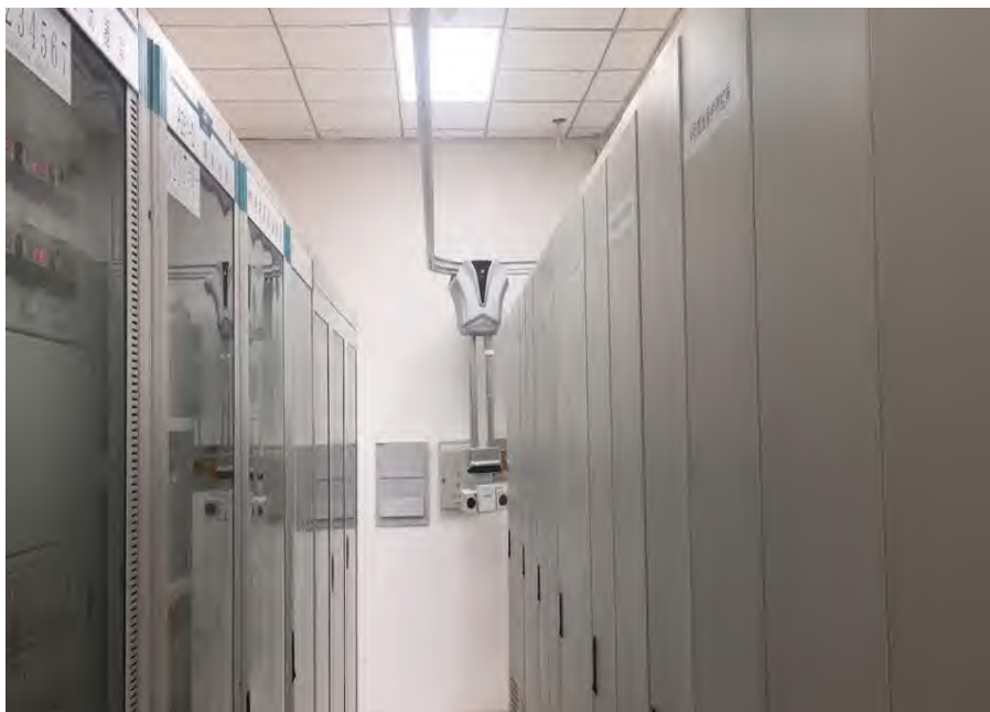
图 153. 轨道巡检机器人功能展示
